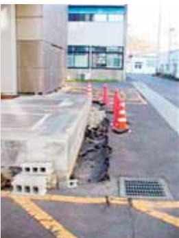
機械・知能系共同棟 外溝 (修繕前)
